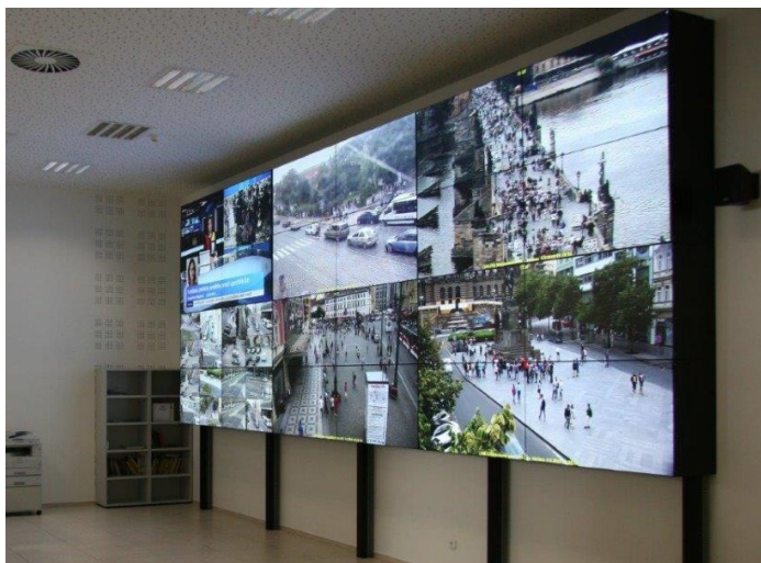
Monitorované pracoviště MKS umístěné na integrovaném operačním středisku PČR KŘ HMP zdroj: PČR KŘ HMP
